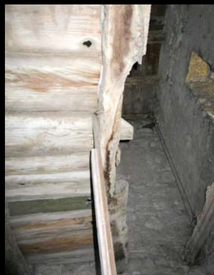
Particolare di uno dei vecchi solai visti dal basso. Sopra il solaio, ovviamente, nessun parapetto di protezione.
